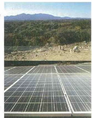
鹿屋・大崎ソーラーヒルズ 太陽光発電所
